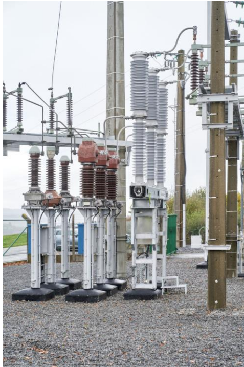
Figure 2.6 : Premier disjoncteur sans SF6 d'une nouvelle génération sur le réseau 70kV d'Elia (sous-station 70kV de Marcourt)
