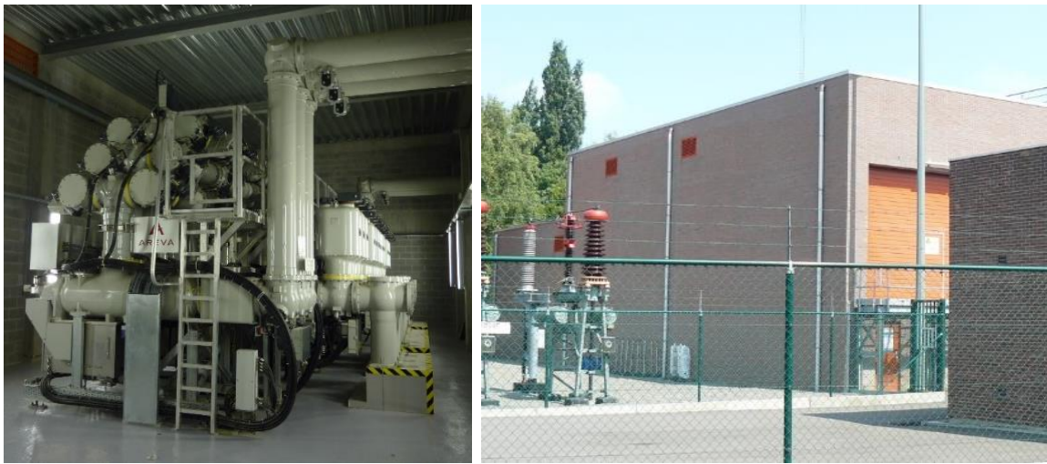
Figure 1.5 : sous-station 150 kV de type GIS
