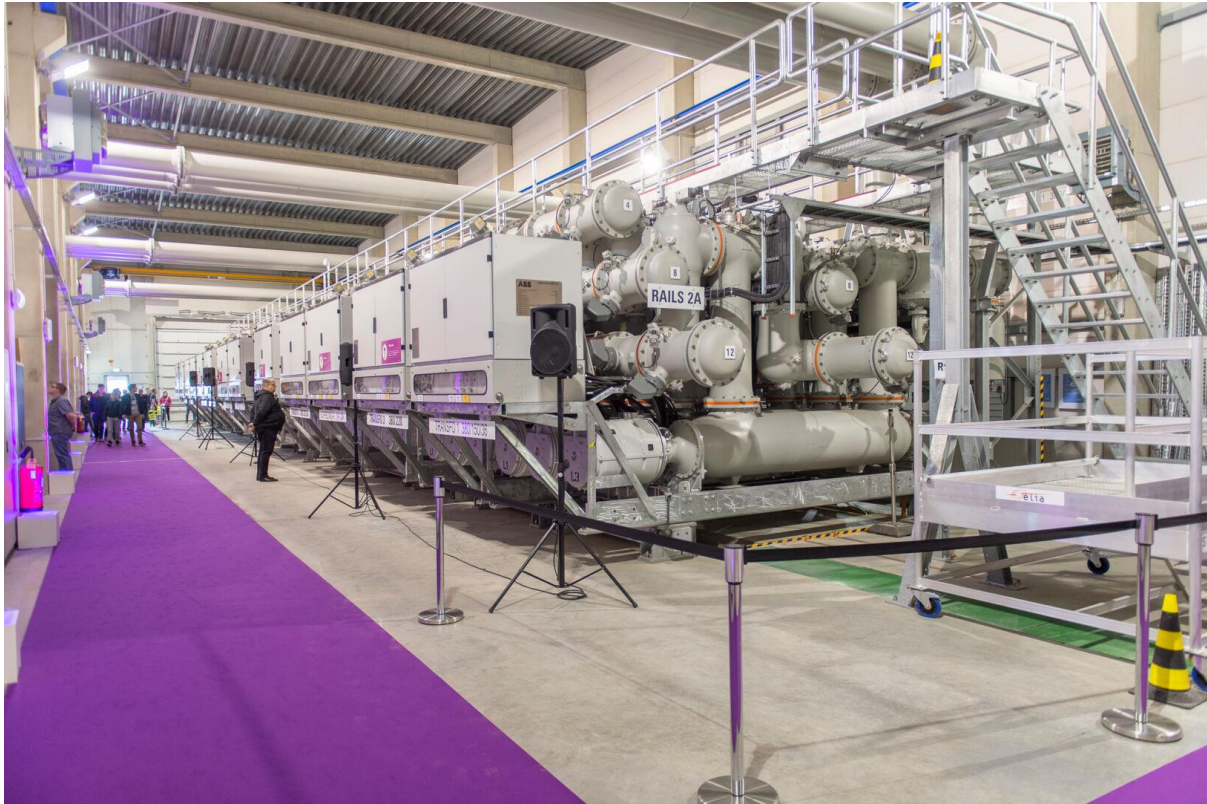
Figure 2.5 : Sous-station GIS de Stevin
