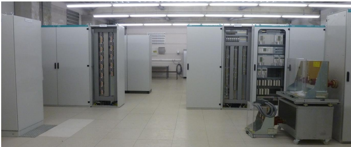
Figure 1.6 : équipements secondaires d'une sous-station
