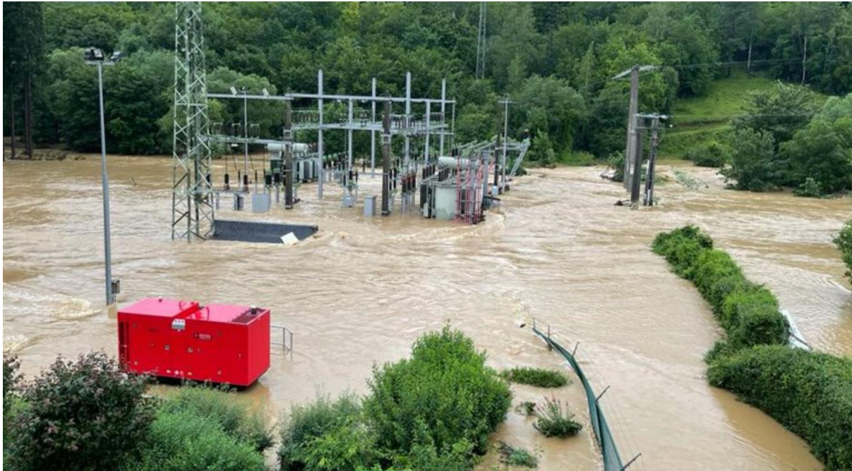
Figure 2.8 : Inondation d'un poste à haute tension suite aux pluies extrêmes de juillet 2021
