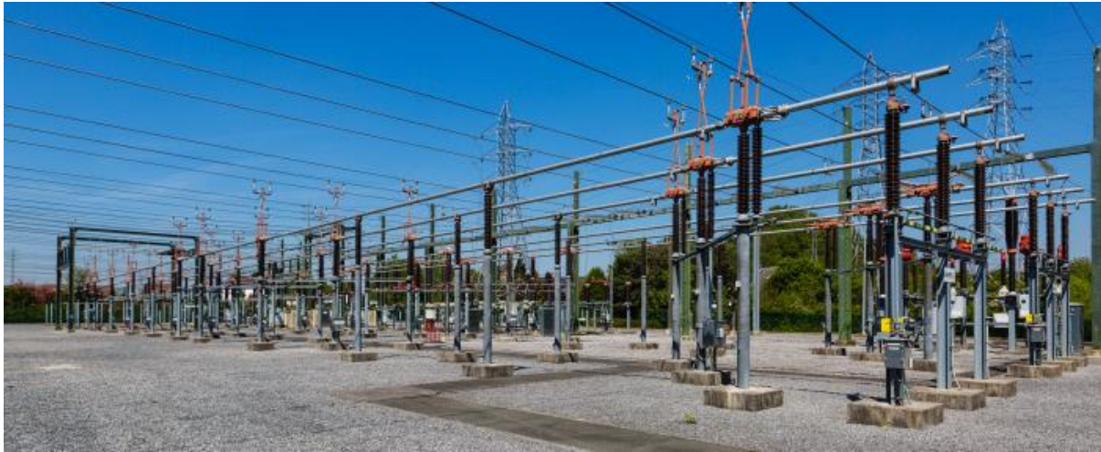
Figure 1.4 : sous-station 150 kV de type AIS
