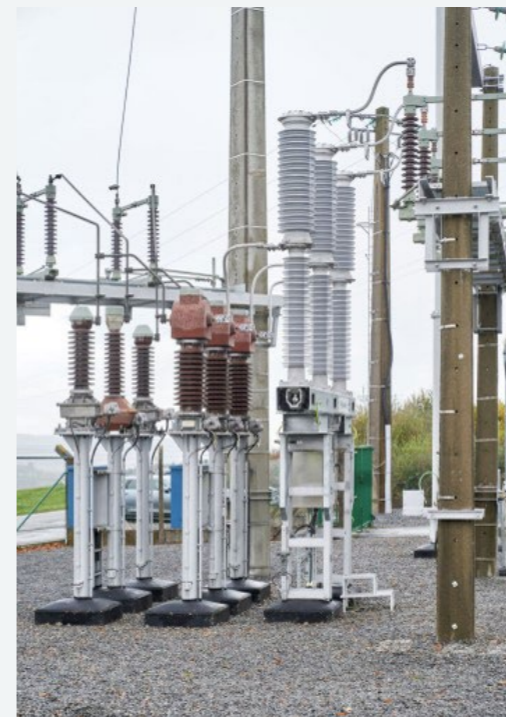
FIGURE 2.60 : PREMIER DISJONCTEUR (ÉQUIPEMENT AVEC LES ISOLATEURS BLANCS DANS LA FIGURE CI-DESSOUS) SANS SF 6 D'UNE NOUVELLE GÉNÉRATION SUR LE RÉSEAU 70KV D'ELIA (SOUS-STATION 70KV DE MARCOURT)
